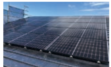
太陽光パネル
